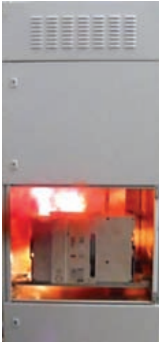
Rövidzárlat-teszt beépített kapcsolóberendezésekkel
